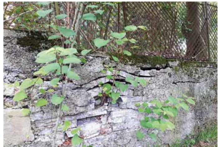
Der Staudenknöterich kann auch Bauwerke beschädigen.
